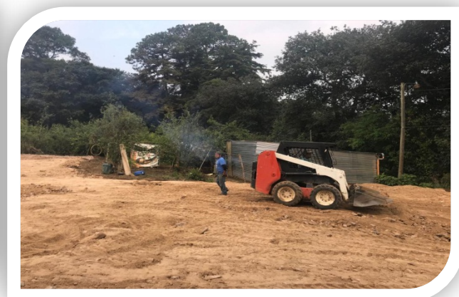
Balastro en predio Municipal
